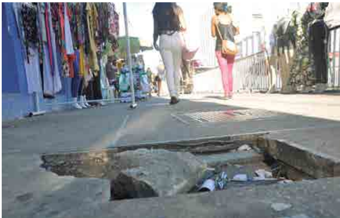
Buracos nas calçadas de João Pessoa já causaram acidentes com idosos, crianças e pessoas com dificuldades de locomoção
